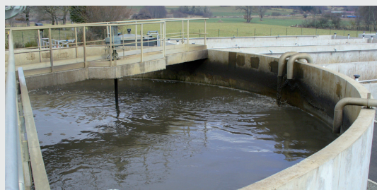
Station d'épuration à boues activées, Noiretable
