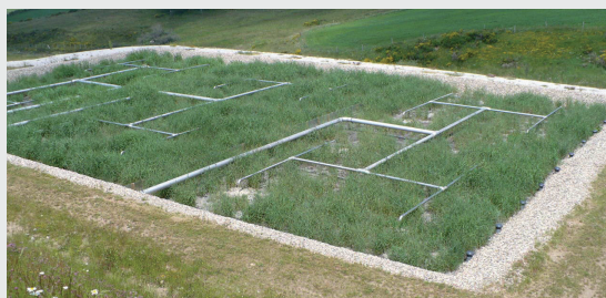
Filtre planté de roseaux, Le Bessat
